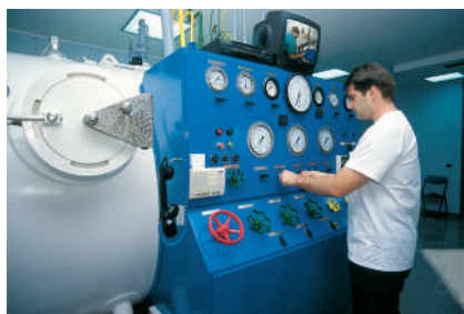
Figura 14. La presurización de la cámara se realiza desde el cuadro de mandos situado en el exterior.
